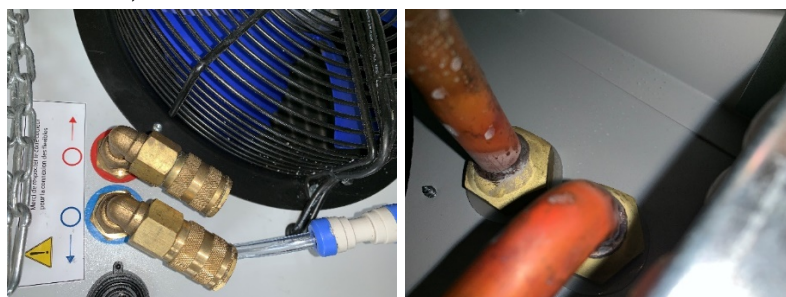
Points de raccordement extérieurs Tubes vus depuis l'armoire intérieure
